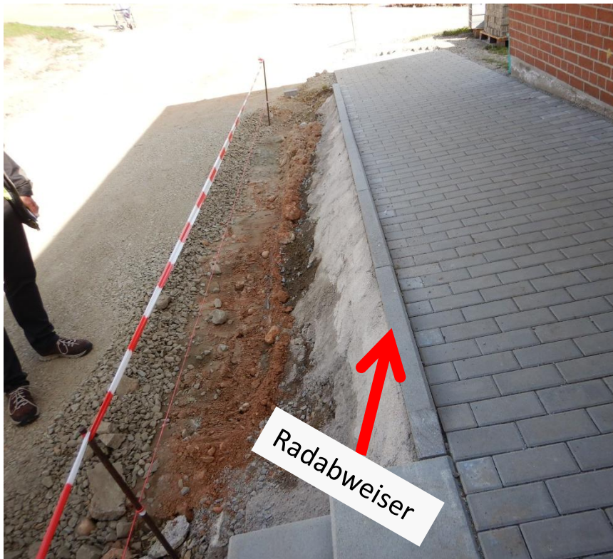
Rampe im Istzustand ohne Markierung: grau in grau Der Radabweiser ist schwer zu sehen. Stolpergefahr!
